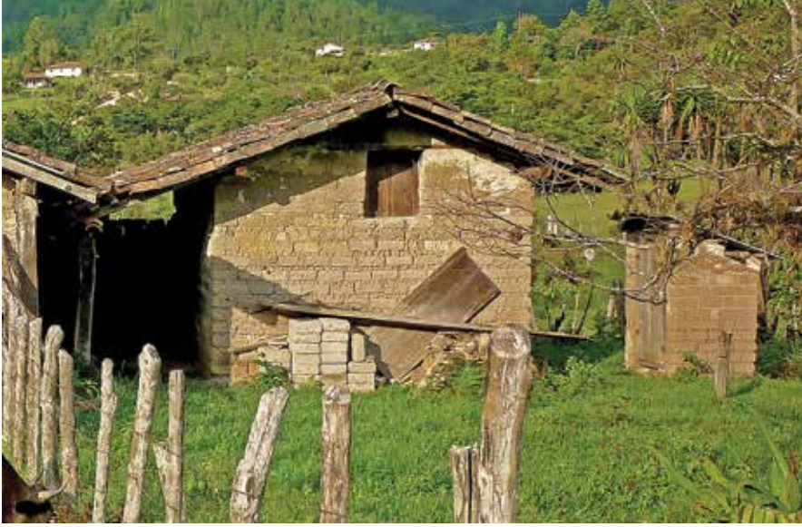
Cocina tradicional acondicionada para refogar productos agrícolas y pecuarios, Santa Cruz, Lempira.
